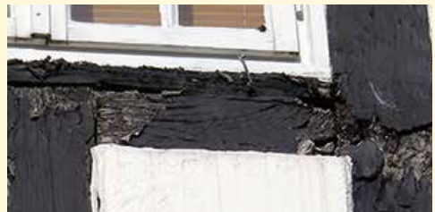
Schäden am Gefache
